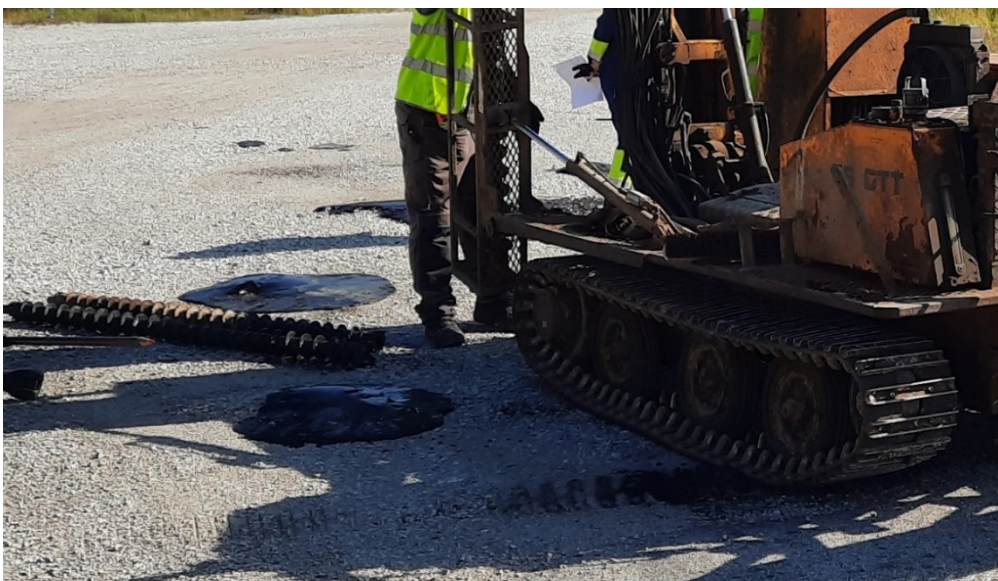
Foto 5. Puuraugu PA48 piirkond, maapinnal on näha bituumenilaadse aine laike.
